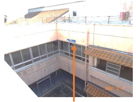
【 波被災高さ表示と斜め屋根裏】
